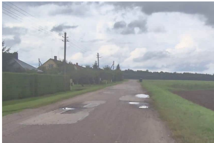
2 pav. Esama kelio būklė Bedalių k.
